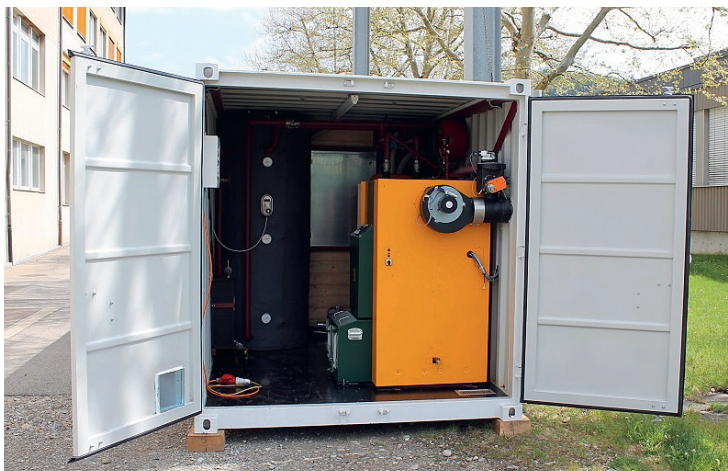
Beispiel für Übergangslösung: Container mit mobiler Energiezentrale, 130 kW Wärmeleistung, Betrieb mit Pellets.
