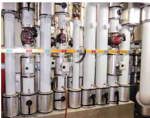
Teilansicht der sekundärseitigen Wärmeverteilung in einem Hotel.
